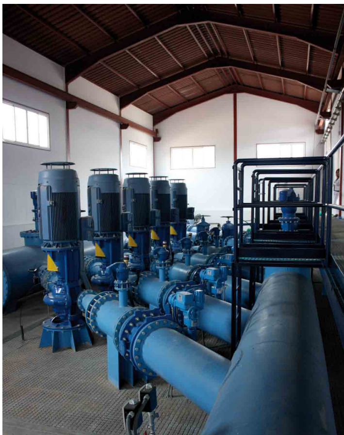
Sala de bombeo de Montemayor.
