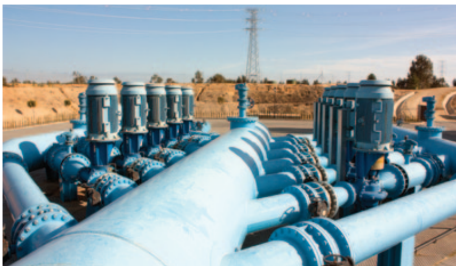
Estación de bombeo de Hidroguadiana.
