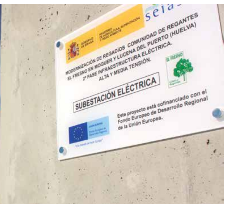
Instalaciones de la subestación eléctrica, en Moguer
